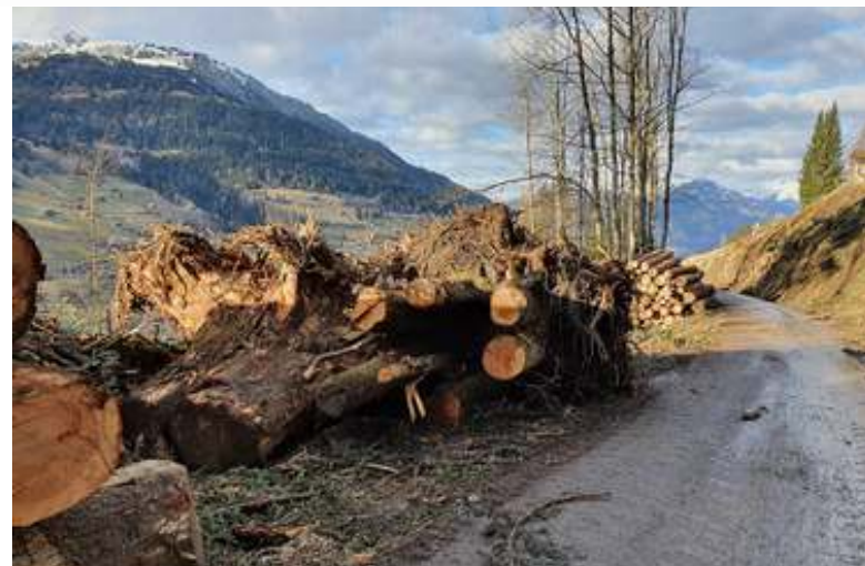
La zone des Champs a été la plus touchée par la tempête et a nécessité de gros travaux du 3 au 21 février dernier.
